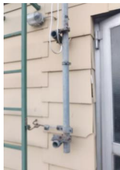
Mast nach Osten Erdung & Einführung
