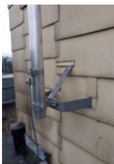
Mast nach Norden Erdung (vorhanden!)
