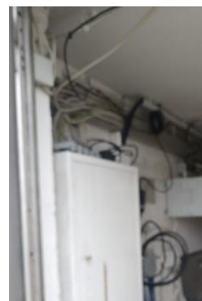
Schaltraum mit 230V (vorhanden!)
